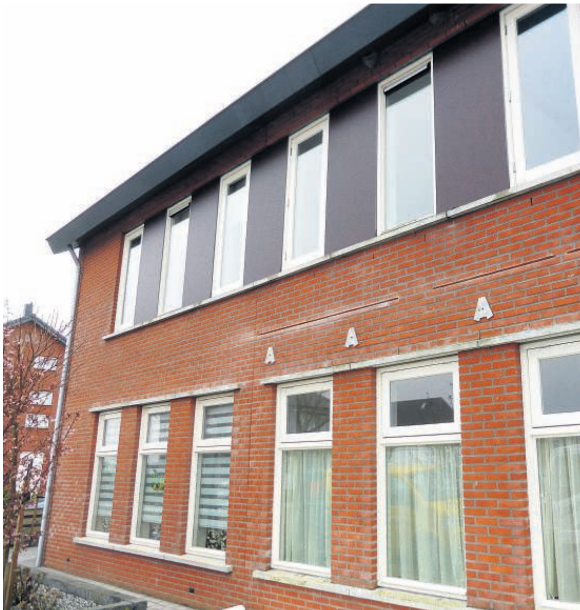
Op de gevel van de testwoningen hebben de ankers de vorm van de A van "aardbeving".
